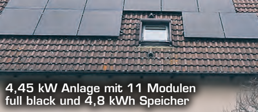
4,45 kW Anlage mit 11 Modulen full black und 4,8 kWh Speicher
