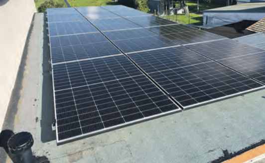
6,15 kW Anlage mit 15 Modulen und 4,8 kWh Speicher
