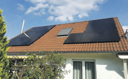
9,72 kW mit 24 Modulen full black und 4,8 kWh Speicher
