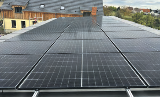
12,3 kW Anlage mit 30 Modulen fullscreen und 9,6 kWh Speicher
