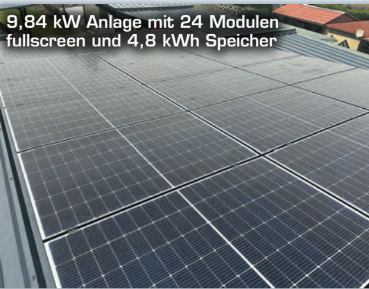
9,84 kW Anlage mit 24 Modulen fullscreen und 4,8 kWh Speicher
